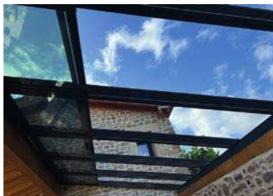
Toit mobile motorisé, adossé au mur et au plafond.
